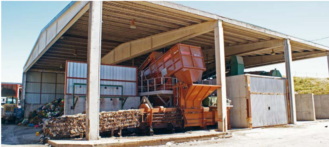
Línea de compostaje de la planta de Cárcar.
